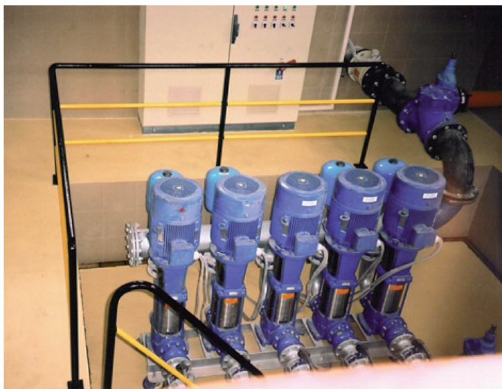
Fotografia 5. Pompownia elektryczna (źródło: Łukomet)
