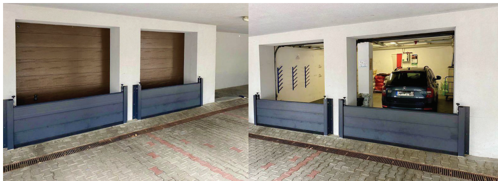
Fotografia 9. Mobilna bariera przeciwpowodziowa w budynku ZUS w Pile, wysokość 60 cm
